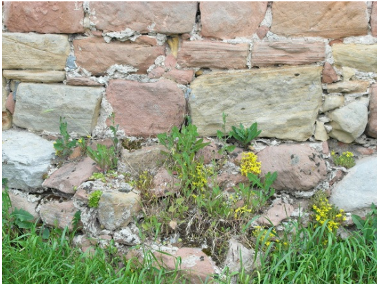
Abbildung 17: Spalten der Stadtmauer
